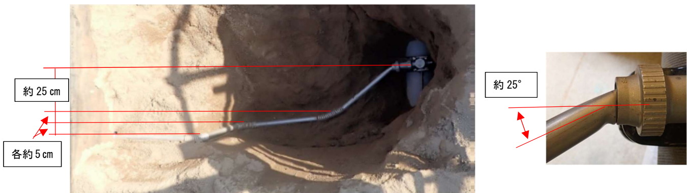
図 7-14 サドル付分水栓及び給水管の変形状況
