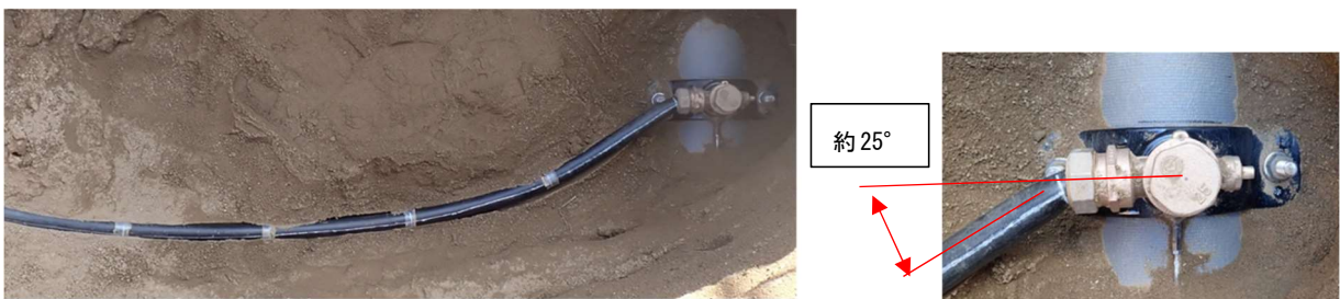
図 7-4 サドル付分水栓及び給水管の変形状況
