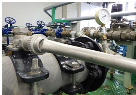
図 7-32 耐震試験後の供試品 2
