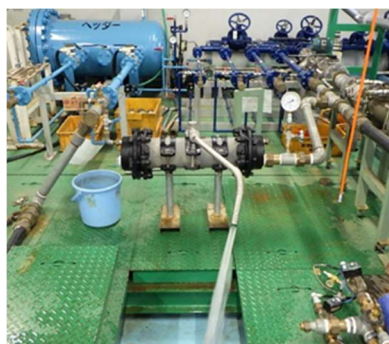
図 7-31 耐震試験後の供試品 1
