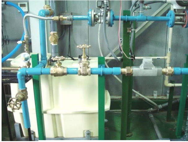
写真7 同時使用バルブ周り
