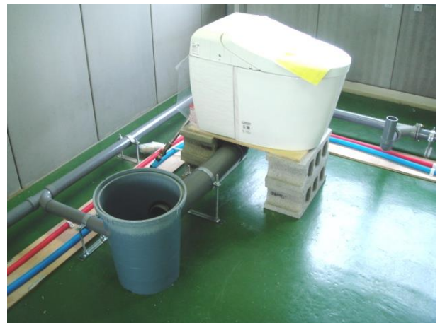
写真 16 タンクレストイレ（異物受け付）
