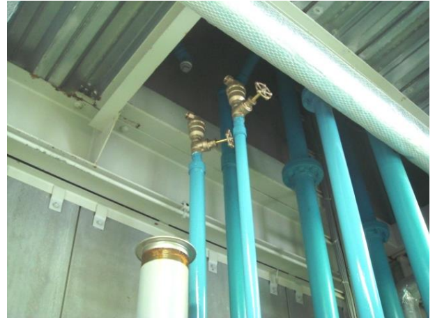
写真8 立管最上部（吸排気弁 20）
