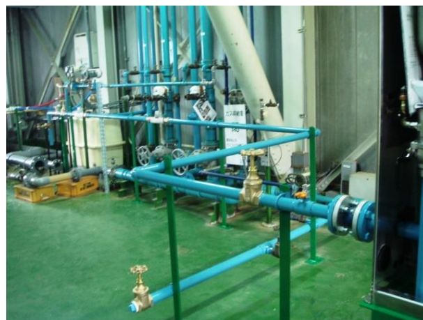
写真4 増圧ポンプ2次側（立管へ）
