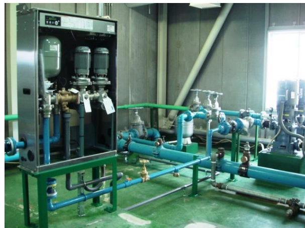
写真2 ポンプと増圧ポンプ周り
