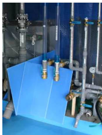
立管基部：50 同径（中央左透明管）
