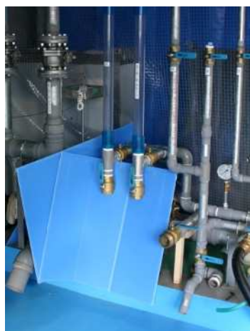
立管基部：50 同径（中央左透明管）
