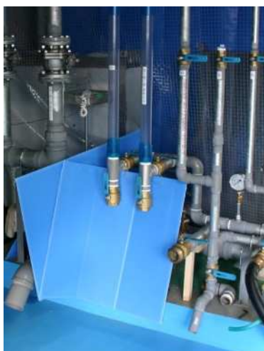
立管基部：50 同径（中央左透明管）
